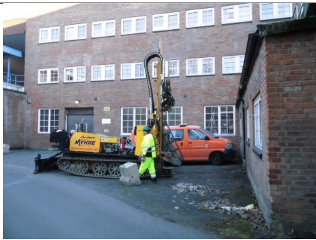
Foto 9. Boring i punkt FM24. Harde masser, mulig pipefundament i grunnen.
