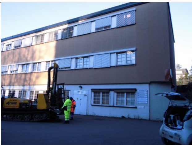
Foto 10. Boring i punkt FM18. Her er det påvist trikloreten og tetrakloreten (det er det også i punkt FM17 og FM21).
