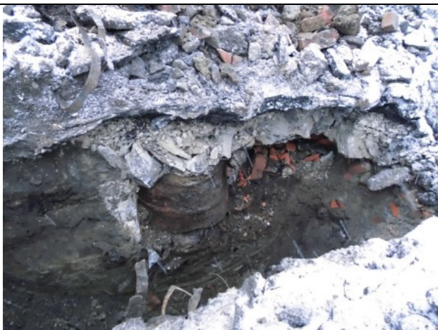
Foto 6. Sjakt FS4. Avfallsinfiltrerte fyllmasser fremkommer tydelig med tegl og en hel tønne. Det er leire i bunn av sjakten.
