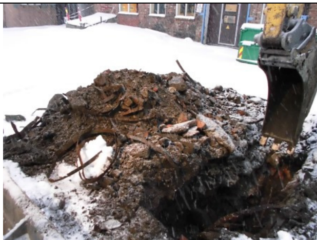
Foto 7. Avfallsinfiltrerte masser fra sjakt FS4.
