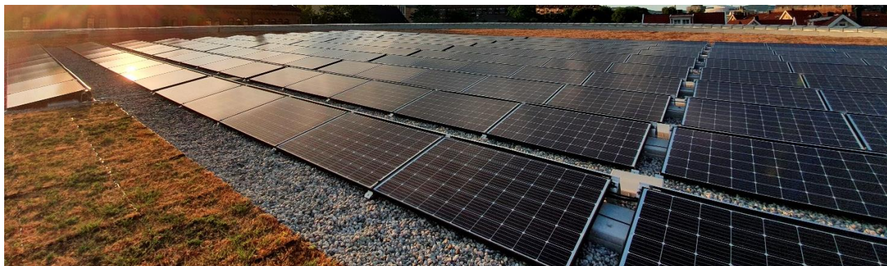
Figur 16: Solcelleanlegg på Jordal Amfi der sedumtak er kombinert med solcelleanlegg i sydvendt-konfigurasjon.
