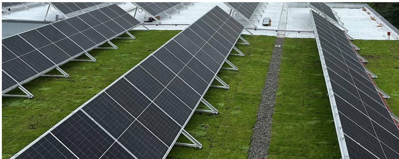
Figur 19: Solcelleanlegg fra Isola Solar på grønt tak ved Fargerike C. Christoffersen i Skien.
