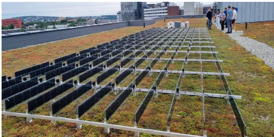
Figur 18: Solcelleanlegg fra Over Easy Solar AS med vertikale solcellepaneler fra pilotprosjekt på Løren skole 2022.
