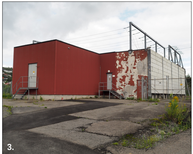
Transformatorstasjon i vestre del (Foto: Lala Tøyen)
